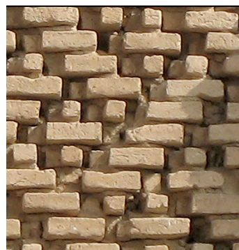
شکل ۱۸. جزئیات تزیینات آجری معروف به نقش حصیرباف ساده در بخش بالای جرز ایوان شمالی
